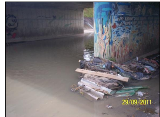
Residuos en puentes vehiculares
