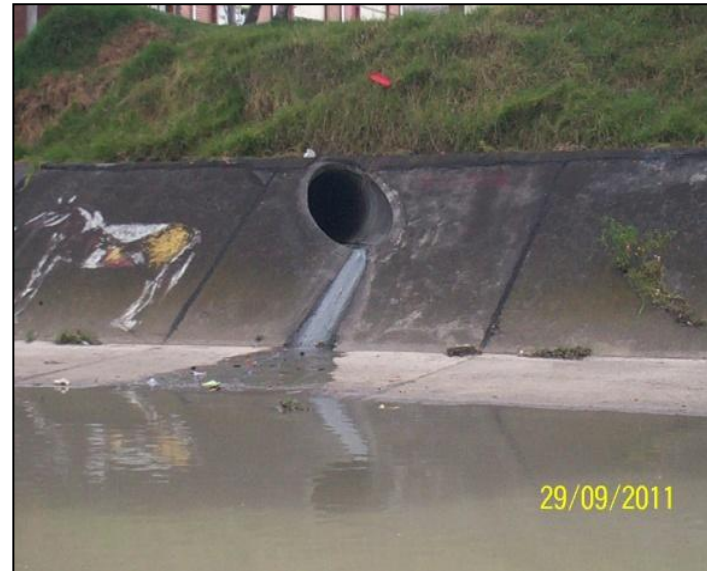
Diagonal 16 sur con Transversal 52ª. Costado sur
