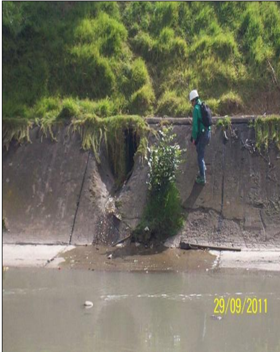
Diagonal 16 sur con Transversal 52ª. Costado sur
